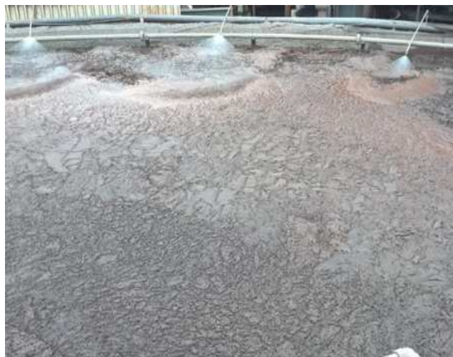
Espessador de Rejeitos.
