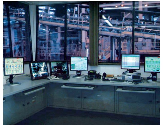
Sala de controle Vargem Grande
